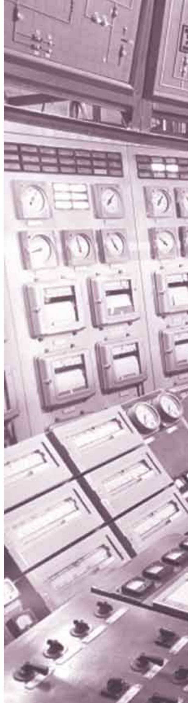
Пульт управления первым энергоблоком Сырдарьинской ГРЭС. Город Ширин.
