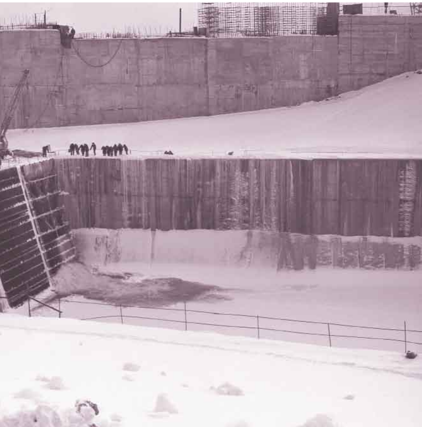
Загорская гидроаккумулирующая электростанция (ГАЭС) на реке Кунье у посёлка Богородское в Сергиево-Посадском районе Московской области. Самая большая из двух действующих в России гидроаккумулирующих электростанций. Является важным структурным элементом энергосистемы Центра России, участвуя в автоматическом регулировании частоты и перетоков мощности, а также покрывая суточные пиковые нагрузки в Московской и Центральной энергосистемах.
