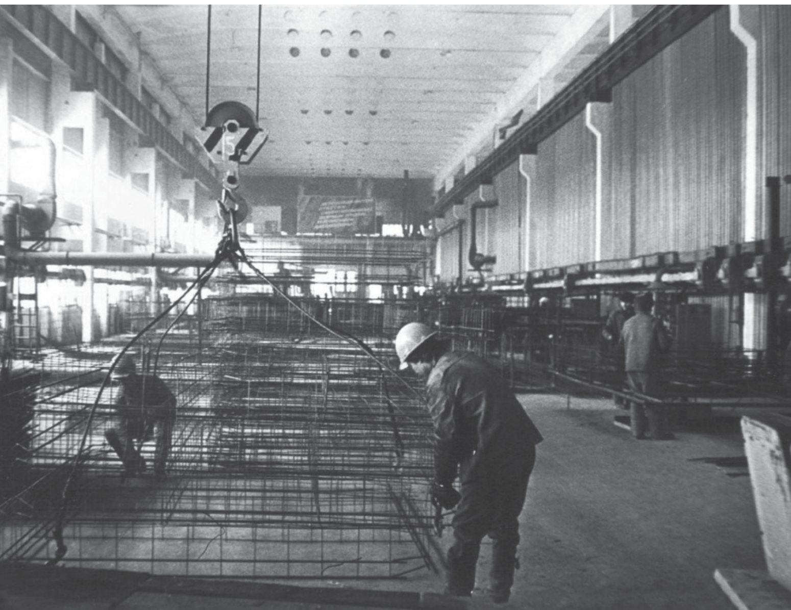
Арматурный цех завода крупнопанельного домостроения
