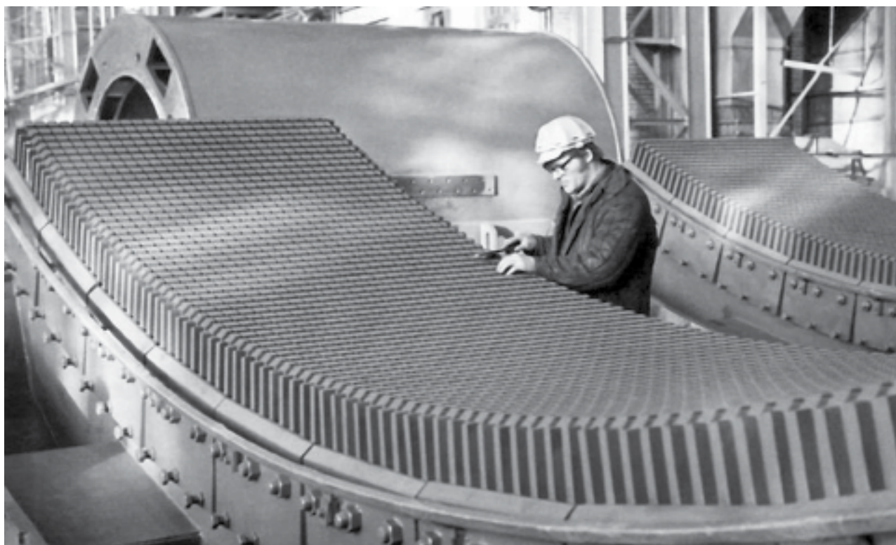
Статор гидрогенератора 220 МВт
